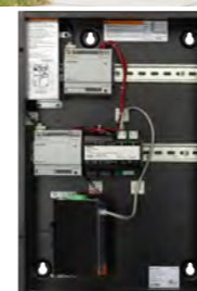
Procesador y módulos de control
